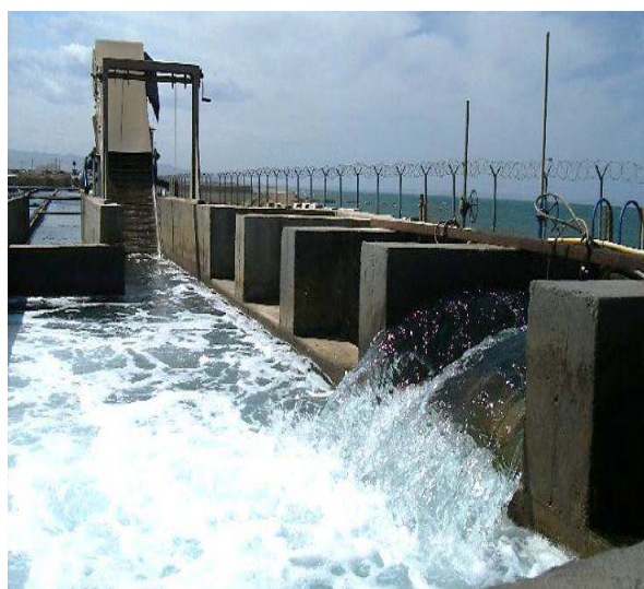
Photo 10 : Alimentation en eau neuve
