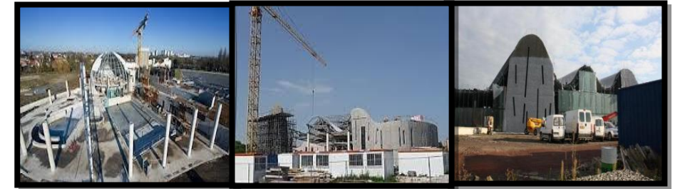
Photo 53: la structure de centre aquatique d'aquarena Source http://www.aquarena.fr/
