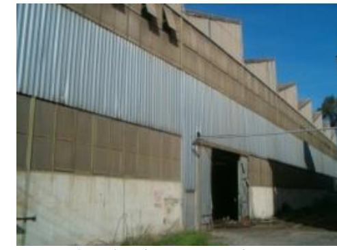
Figure 54: Atelier des moteurs techniques, Source : auteur
