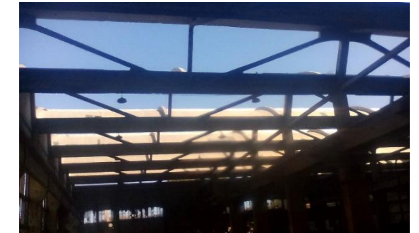
Figure 61: l'atelier d'appareillage, Source : auteur
