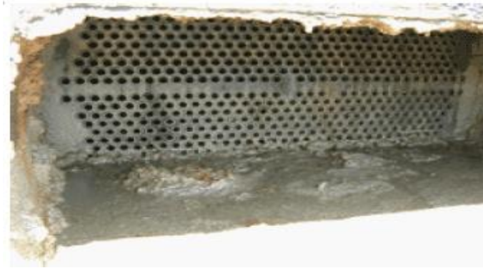
Figure III.4 : Dépôt de slime bactérien, hydrocarbures et oxydes métalliques dans un échangeur de chaleur eau hydrocarbures (raffinerie de pétrole)
