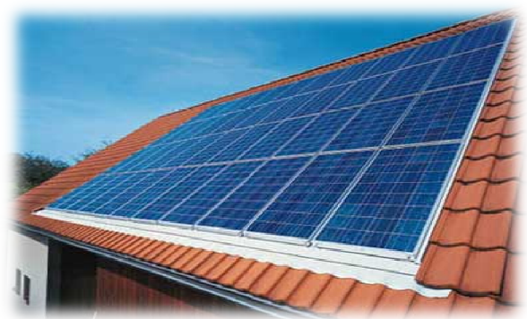
Figure II-21 : Photo un Photovoltaïque placer sur un Touille
