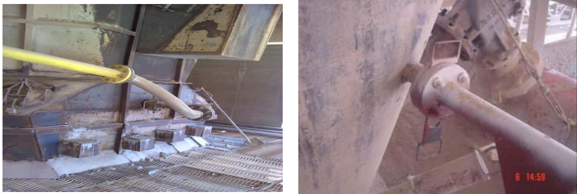
Fig. II.1. Injection du gaz naturel au fond du cyclone 3 de la Tour de préchauffage de la farine crue
