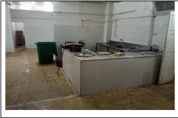
Photo n° (04) : faïence inférieure de 2 mètres avec des angles mur-mur et mur-sol aigues. (pp).
