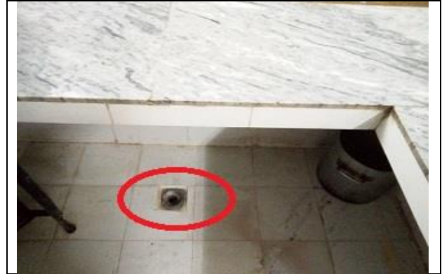
Photo n° (05) : un siphon qui présente un accès pour les nuisibles. (pp).
