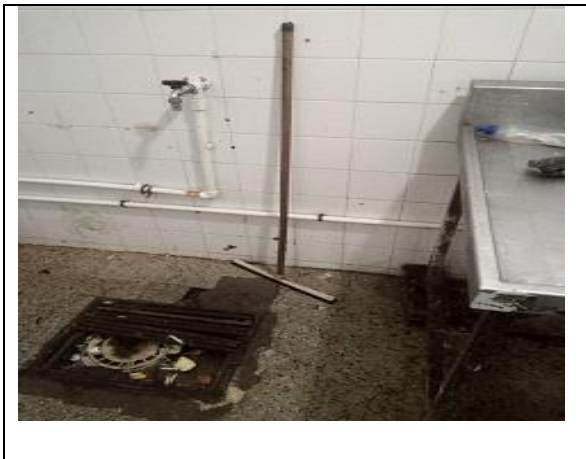
Photo n° (02) : système de siphon ne répond
