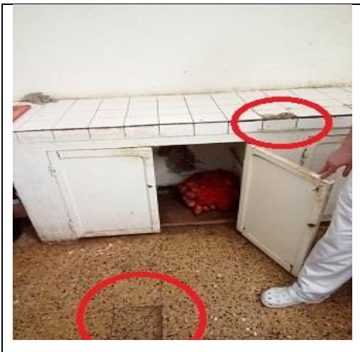
Photo n° (06) : sol et faïence corrodés (nids à microbes). (pp).
