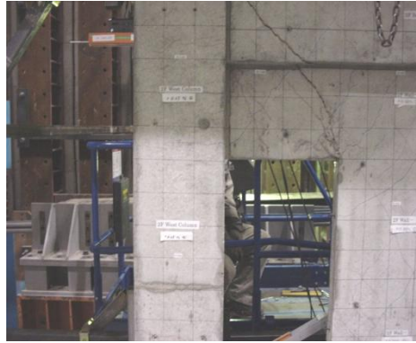
(a) Fissure de cisaillement dans la poutre du 2 ème niveau
