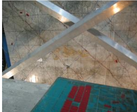
(b) Fissures de cisaillement dans le panneau de voile du 2 ème niveau
