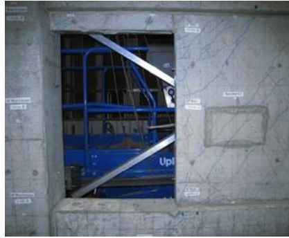
(a) Fissures de cisaillement dans le panneau de voile du 2 ème niveau
