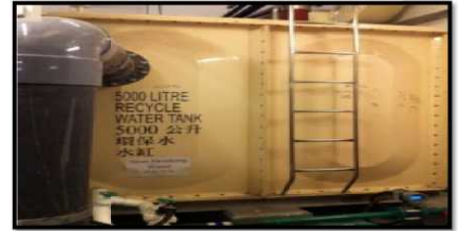
Figure 37 Réservoir de récupération d'eau de pluie.
