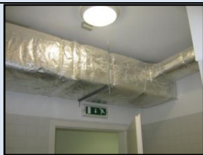
Figure 251 : réseau de ventilation Source : http://www.martinsoliveira.pt/fr/3/services
