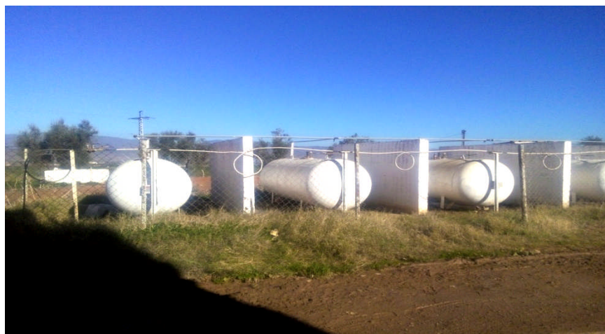
Figure 17 : Citernes de gaz
