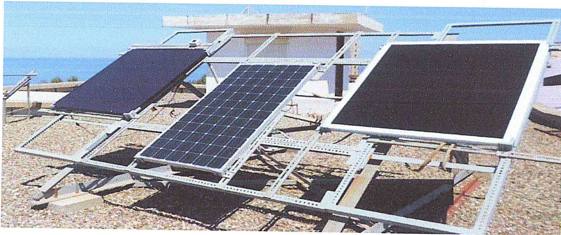
Figure III.1 Plateforme de tests des modules photovoltaïques de l'UDES
