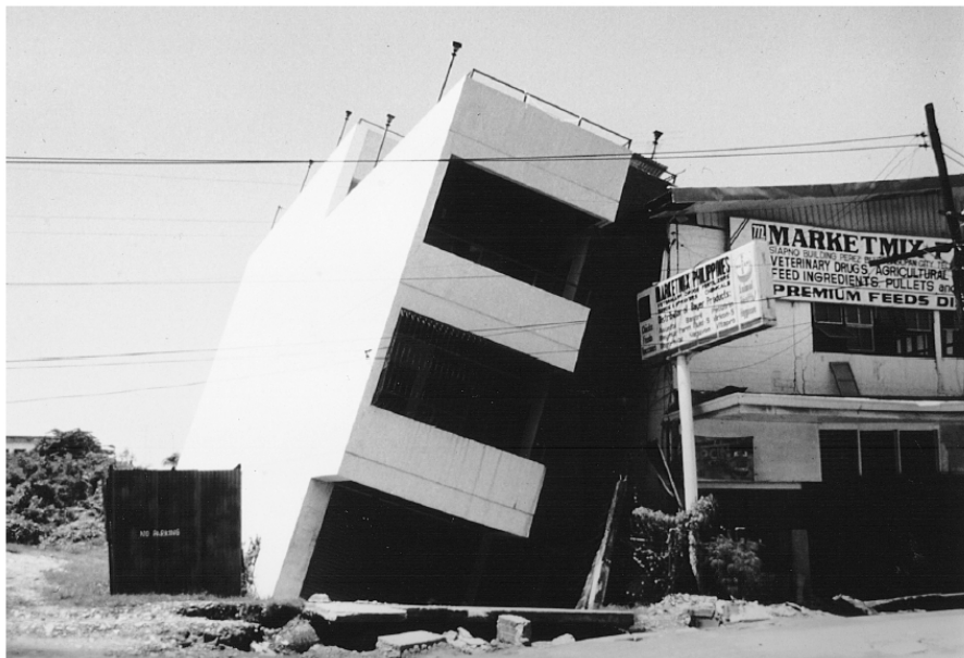
Figure. 2.4: Rupture de la capacité portante des fondations d'un bâtiment durant le séisme de Philippines.
