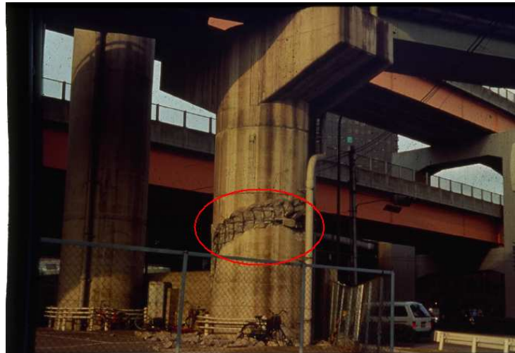
Séisme de Kobé –Japon 1995 [26]
