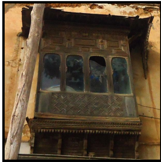
Kâabou en bois richement décoré en sculpture avec quatre ouvertures qui se trouve dans la façade secondaire.
