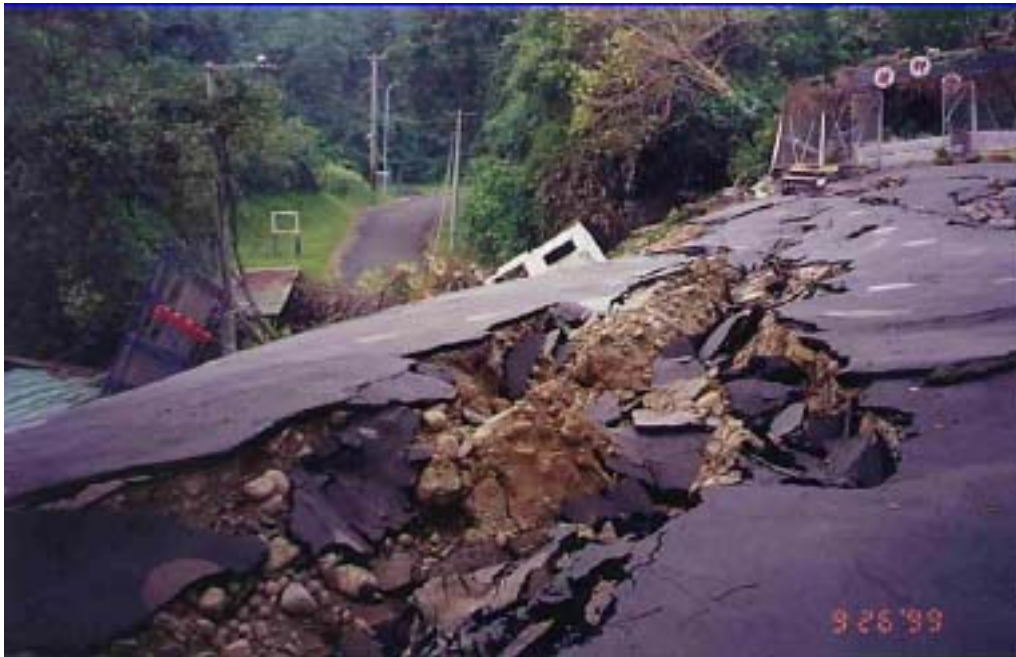
Figure 1.4 : Détérioration du réseau routier (Yualin, 1999) [2].
