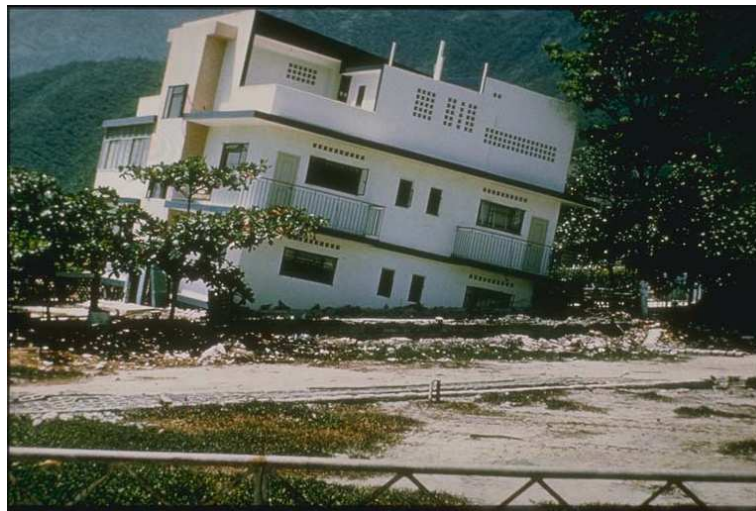
Figure 5.3 Basculement d'une résidence par tassement différentiel du a la liquéfaction. Tremblement de terre Venezuela 1967
