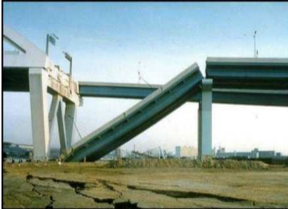
Figure 5.4 a) Rupture du pont Nishinomiya. Tremblement de terre de Kobe Japon 1995
