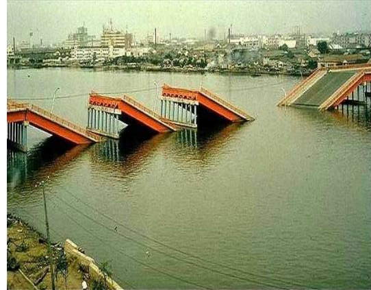
Figure 5.4 b) Effondrement du pont Showa. Tremblement de terre de Niigata 1964
