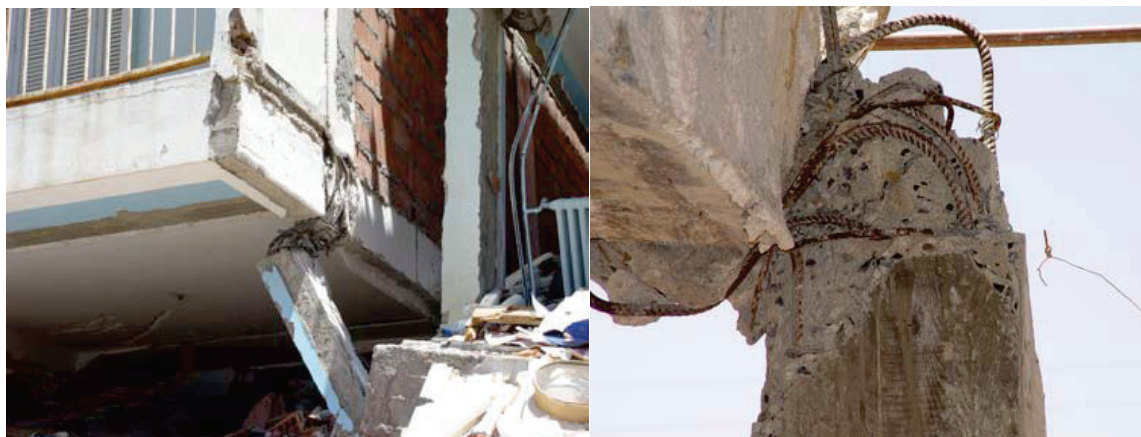
Figures 3.22 et 3.23 : Endommagement et destruction de l'extrémité du poteau du fait de l'absence d'armatures transversales dans la zone nodale (zone critique du poteau)
