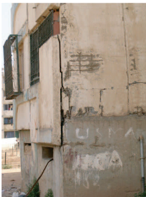
Figure 3.26 : Fissures au niveau de la jointure des panneaux préfabriqués et la structure
