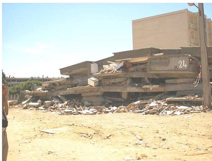
Figure 3.6 : Structure totalement ruinée*
