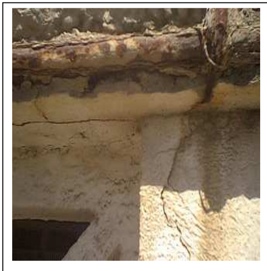
Figure III-11 Exemple d'une poutre appartenne à un portique exposé vers le mouvement du soleil, Boulourinne
