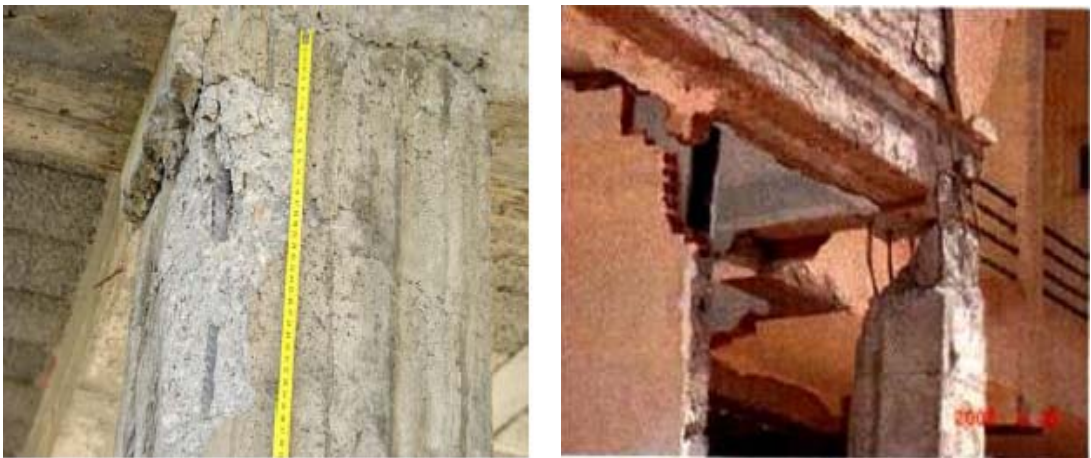
Figure 1.23 : Manque ou absence des armatures transversales
