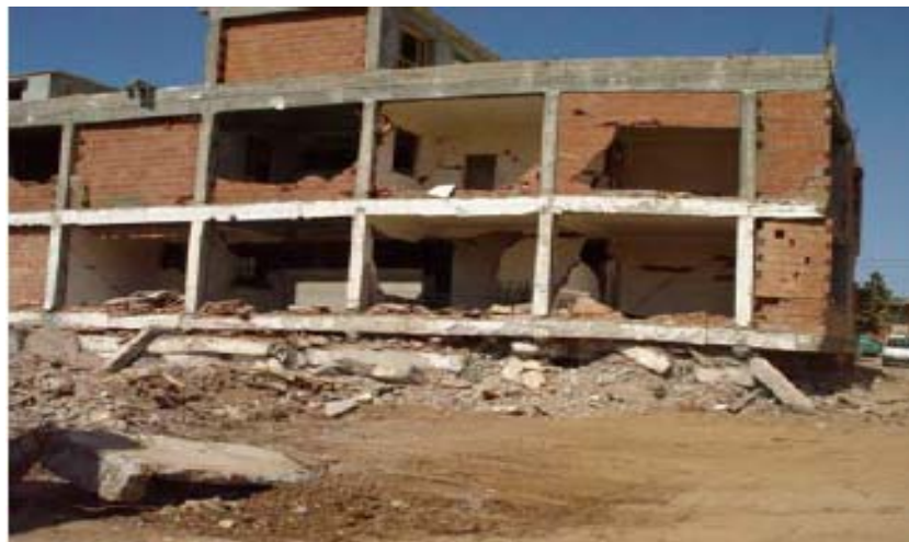
Figure 1.31 : Effondrement total du RDC et chute brutal des étages supérieurs
