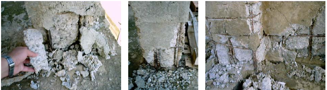
Figure 1.28 : Ségrégation du béton au niveau des nœuds des poteaux
