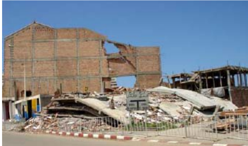
Figure 1.33 : Effondrement par collision
