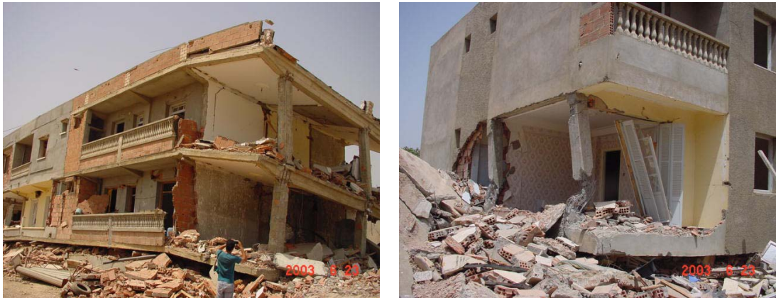
Figure 1.15 : Dégâts des structures en portiques
