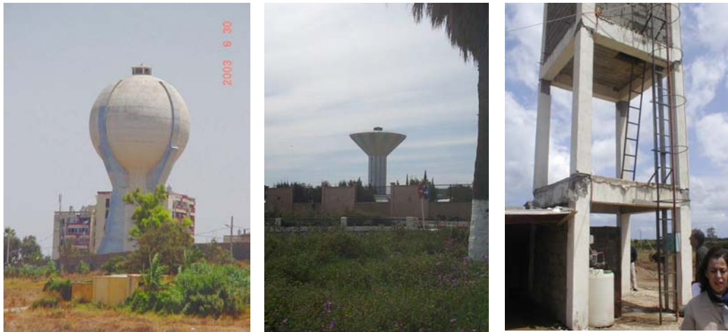
Figure 1.19 : Etat des châteaux d'eau
