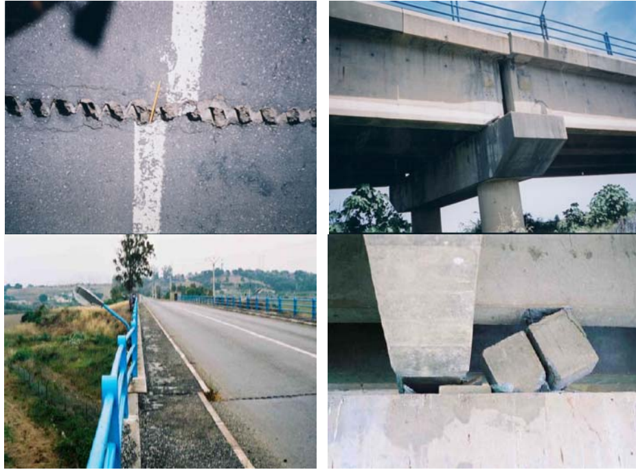
Figure 1.21 : Dégâts observés sur les ouvrages d'arts (ponts)
