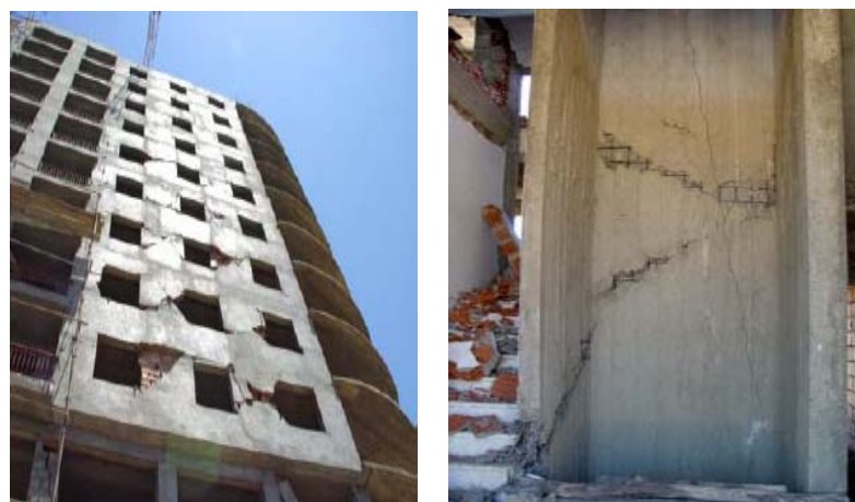
Figure 1.14 : Endommagement des ouvrages avec voiles
