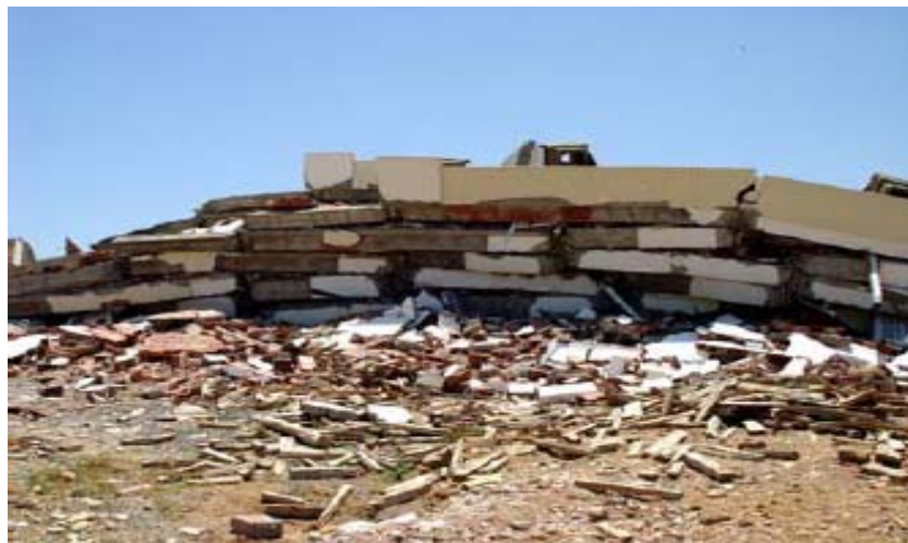
Figure 1.32 : Effondrement total de la structure
