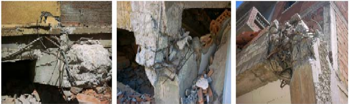
Figure 4.3 : Dommage local du poteau
