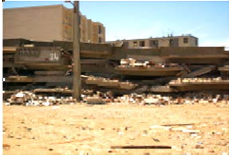
a) Cas d'effondrement total, Bâtiment N°24.
