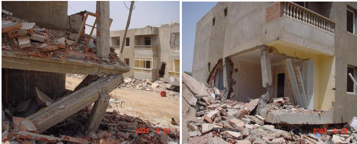
Figure 4.13 : Cisaillement des poteaux du niveau Rdc des bâtiments étudiés
