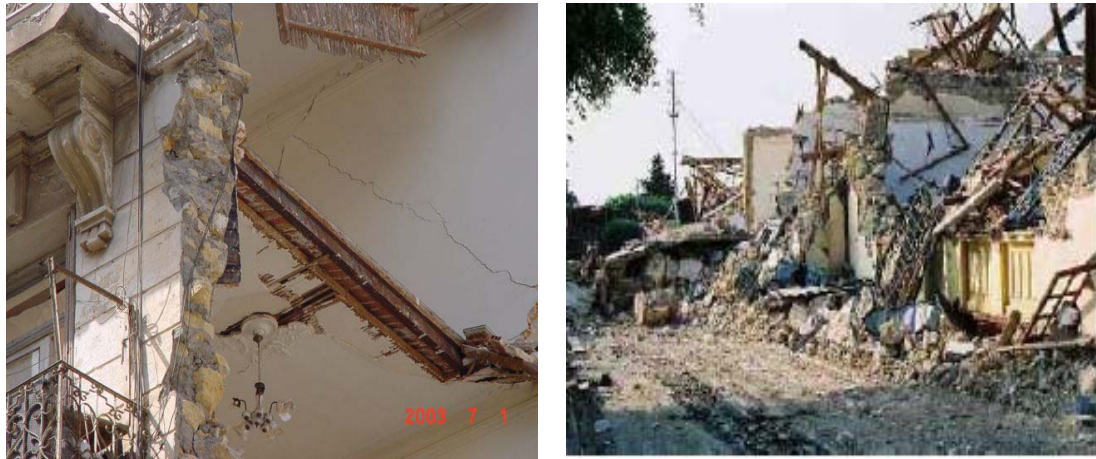
Figure 1.13 : Endommagement des ouvrages en maçonneries.
