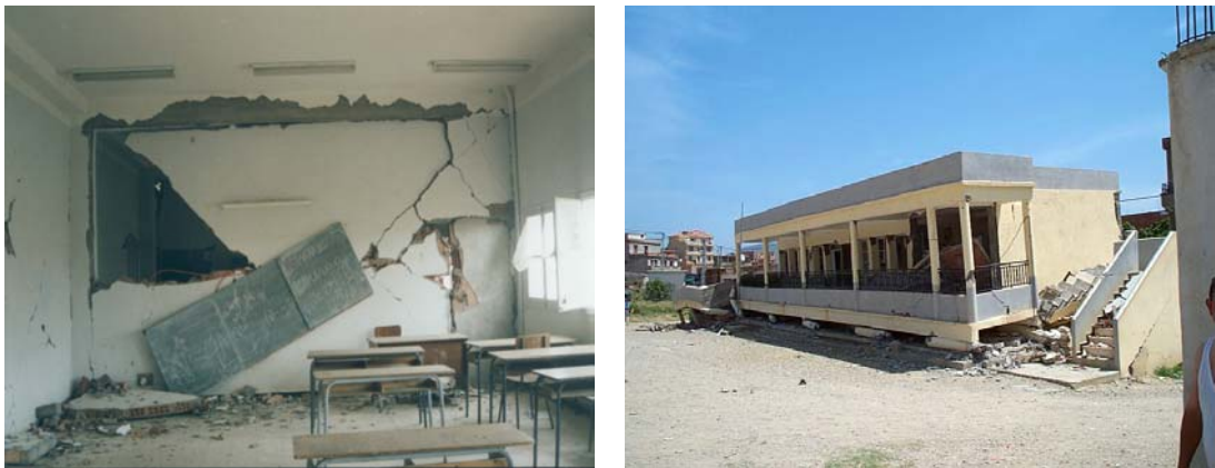
Figure 1.16 : Dégâts observés dans les écoles
