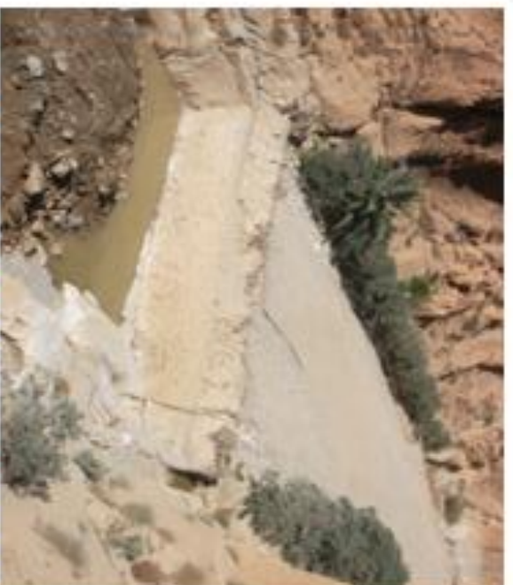
Figure 34 : barrage de distribution
