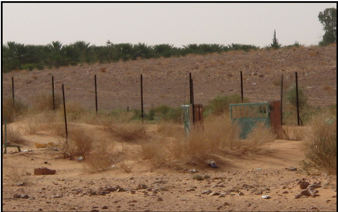
Photo 4.2 Station d'assainissement autonome
