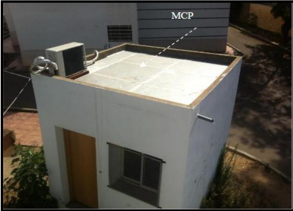
Figure 34: une couche de MCP inséré sur le toit d'un local
