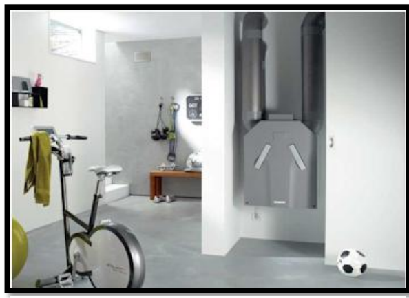
Figure 7: le puits canadien à l'étage de la maison
