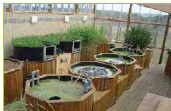
Traitement des eaux usées
