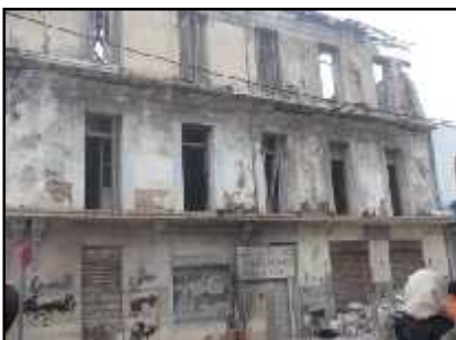
FIG 18.01 : Dégradation sur le plan architectural de la ville d'Ain El Banian. Source: Auteurs 2015
