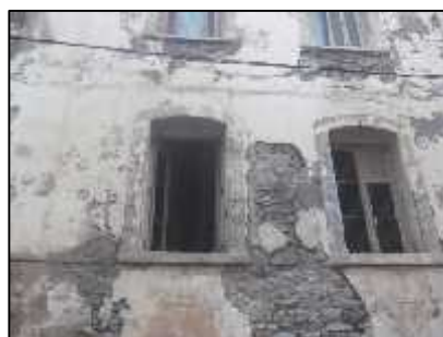
FIG 19.01 : Dégradation sur le plan architectural de la ville d'Ain El Banian. Source: Auteurs 2015
