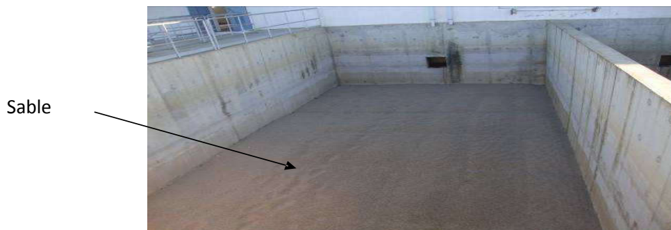
Figure 11 : Filtre vide et à l'arrêt. (Photo originale)
