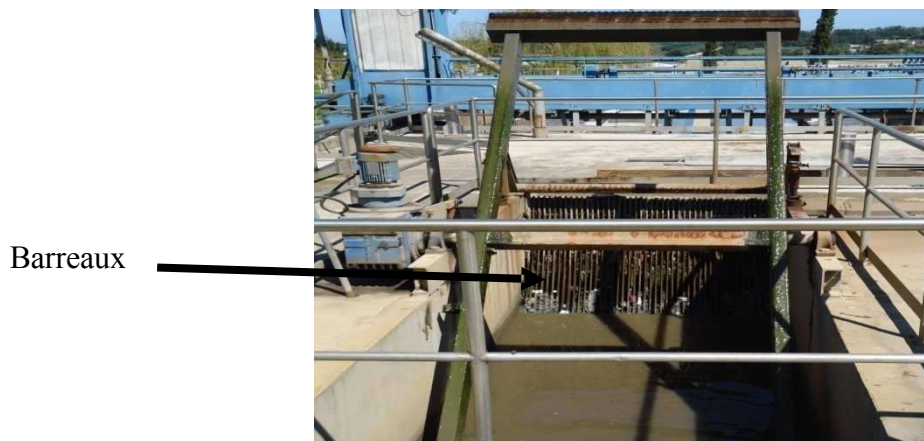
Figure 5: Dégrilleur automatique. (Photo originale)
