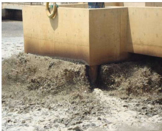
Figure 9 : Bassin d'aération (Photo originale)
