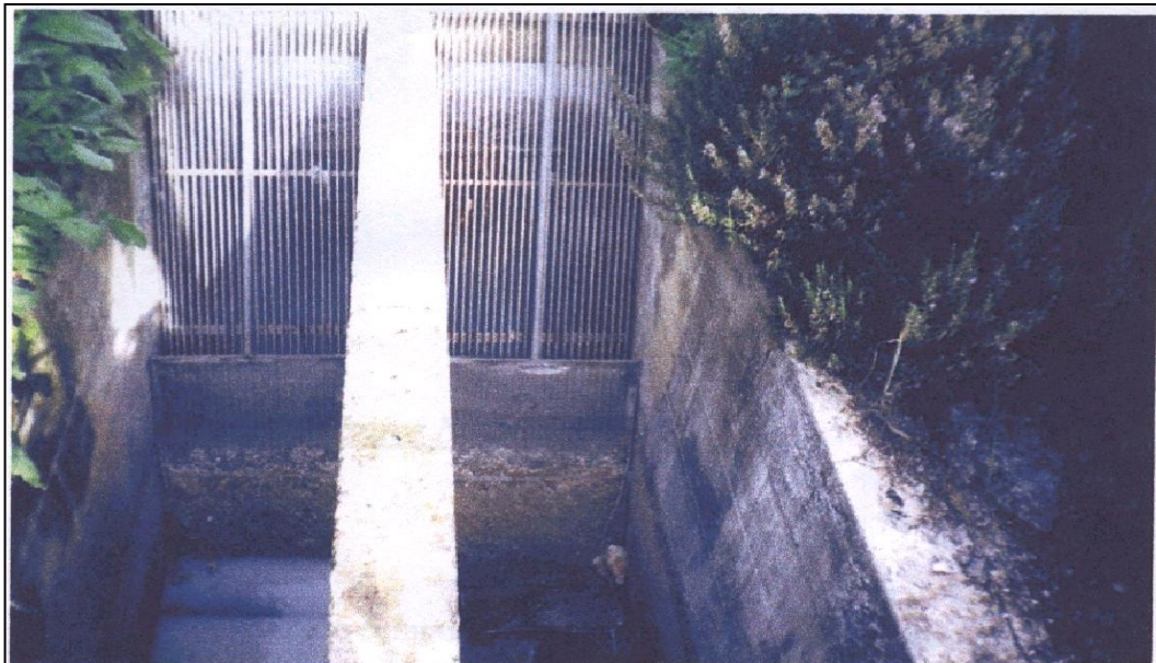
Photo N° 1 : Dégrillage (deux grilles à barreaux)
