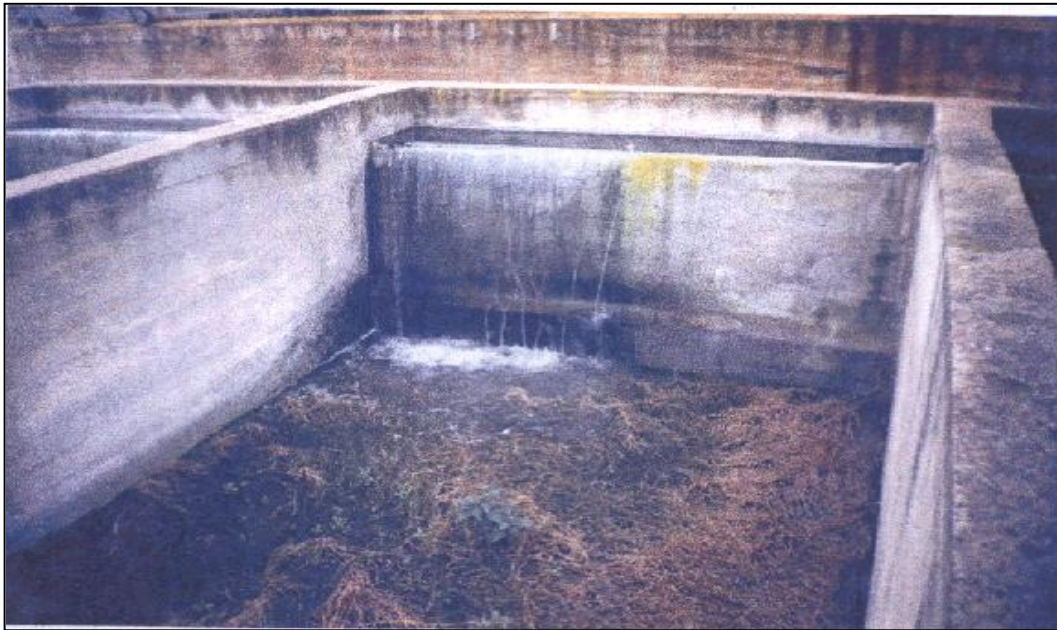
Photo N° 8 : Filtre à sable
