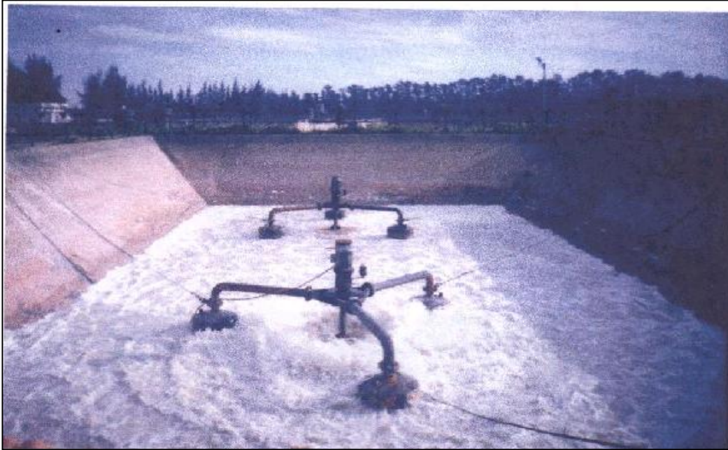
Photo N° 4 Bassin de neutralisation
