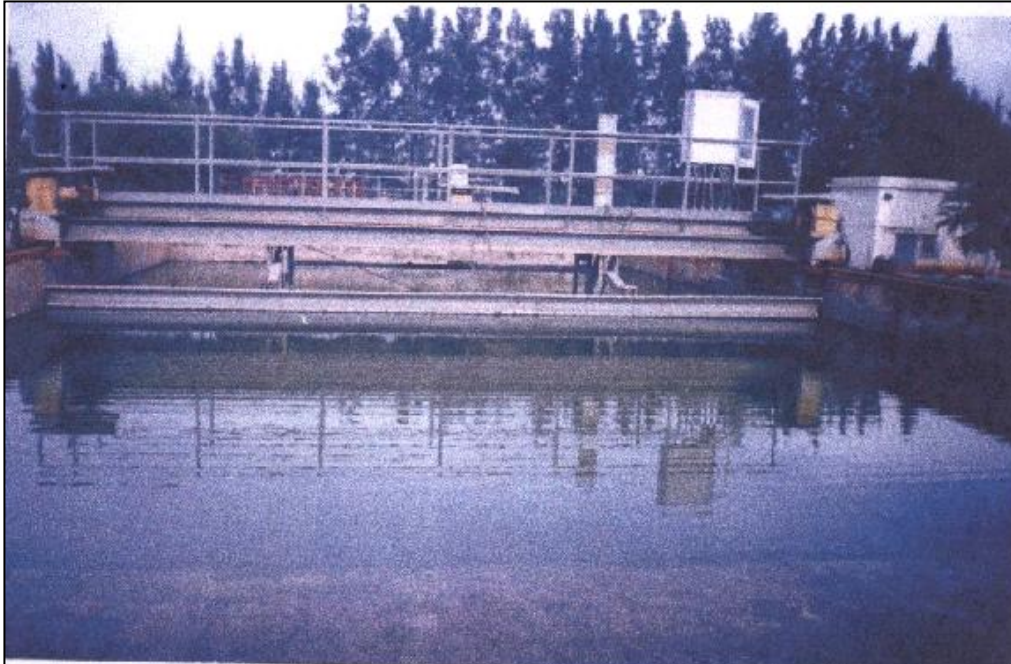
Photo N° 7 : Bassin de décantation
