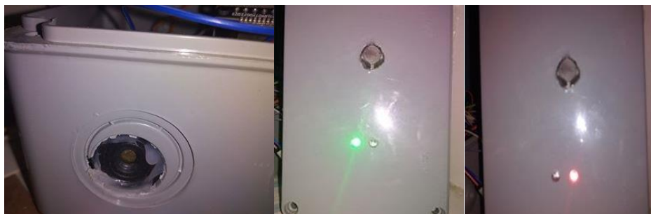
Figure 103 Alerte via une alarme sonore et visuelle (la LED rouge est allumée lors d'une situation dangereuse)
