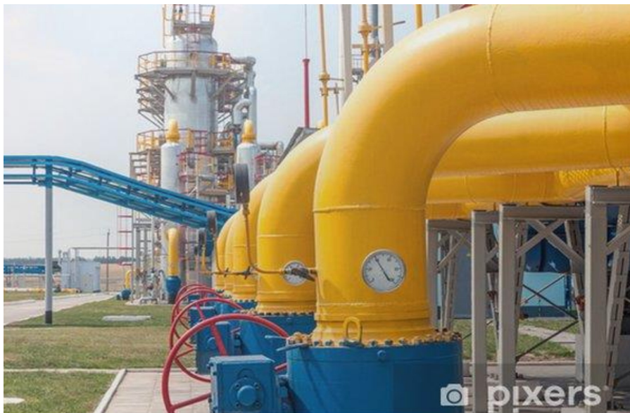
FIGURE 1.5 – Une station de compression de gaz en journée d'été
