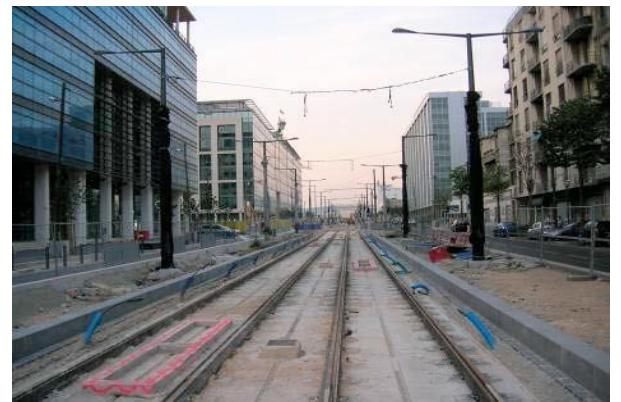
Figure 2.40 : ligne de tramway en chantier sur le Boulevard de Dunkerque, boulevard séparant quartier d'affaires et quartier d'habitat
