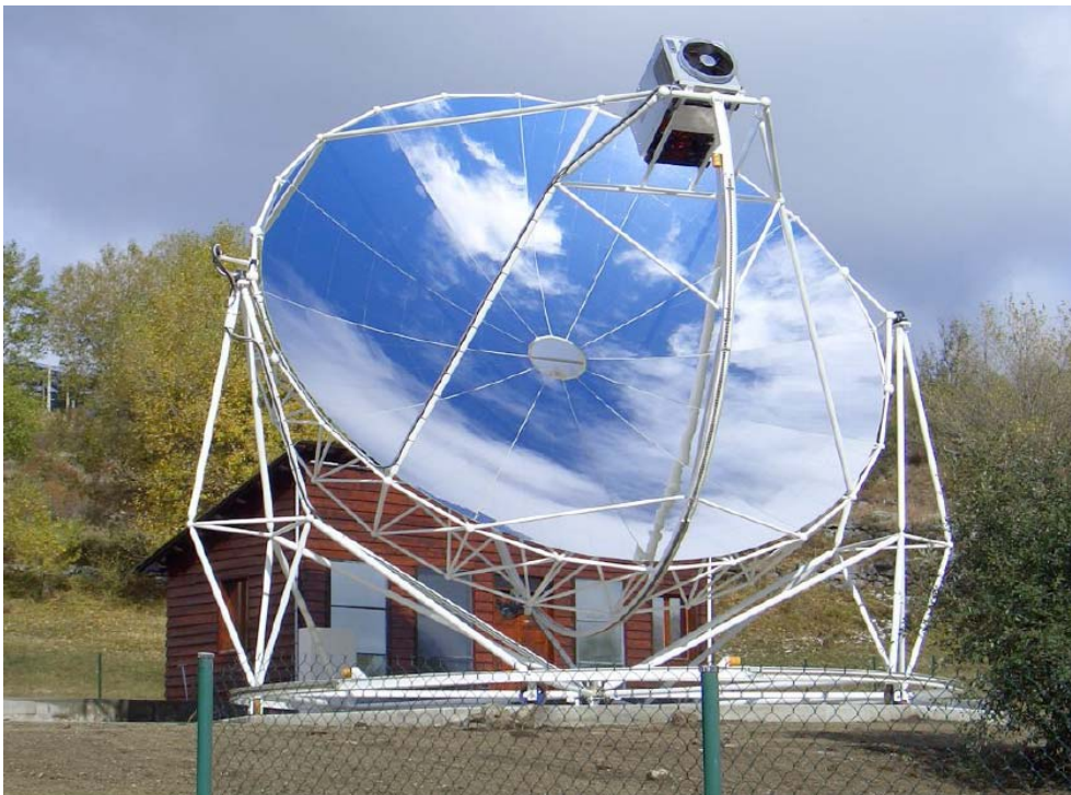
Figure 1.29: Le système "EURODISH" installé à Odeillo (France)
