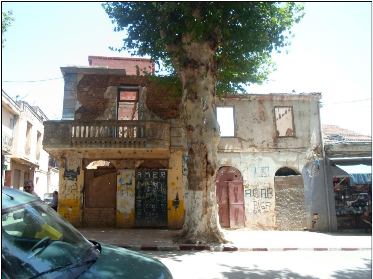
Figure I.1 Façade comportant des fenêtres délabrées, rue Emir Abd El Kader, Miliana
