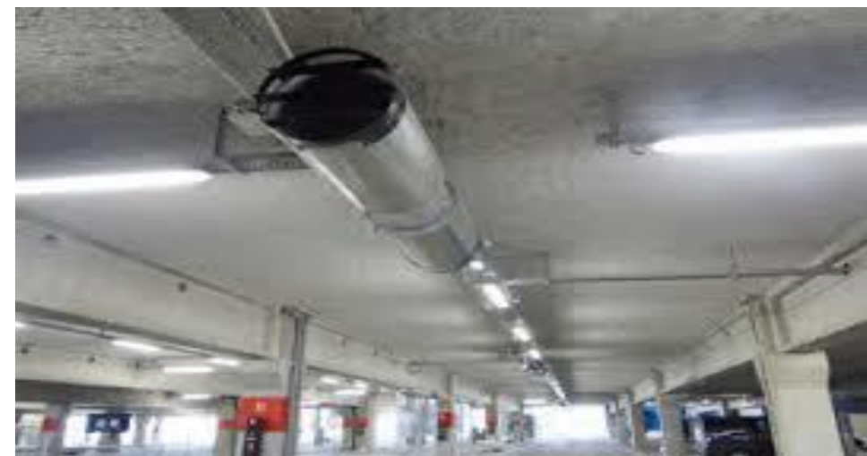
une ventilation mécanique
