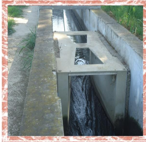
Figure N°09 : Canal venturi de comptage des eaux épurées (photo originale).
