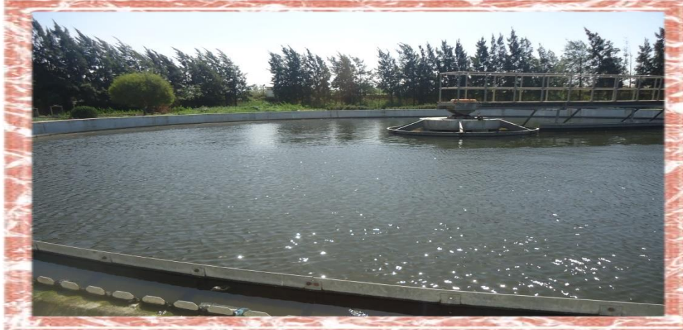
Figure N°08 : Vue d'ensemble du clarificateur (photo originale).
