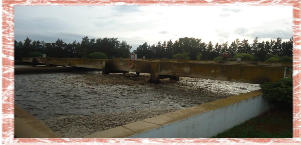
Figure N°06 : Bassins d'aérations (photo originale).
