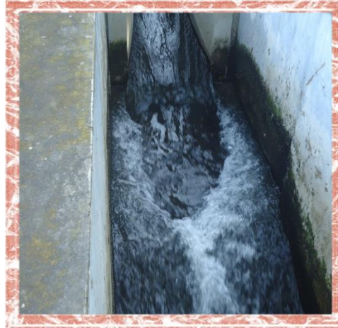
Figure N°10 : Rejet d'eau épurée (photo originale).
