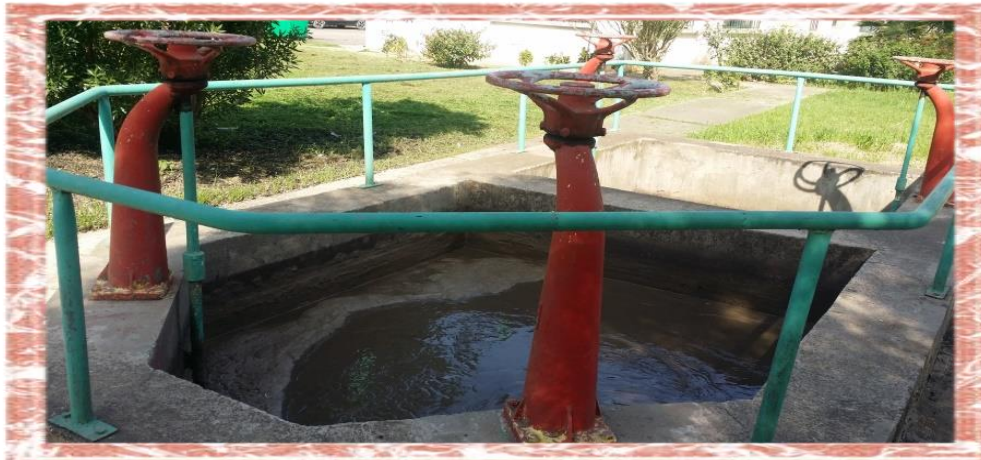
Figure N°07 : Dégazeur (photo originale).
