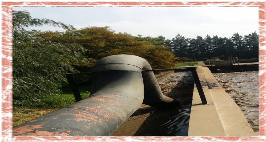
Figure N°11 : Pompes de recirculation (photo originale).
