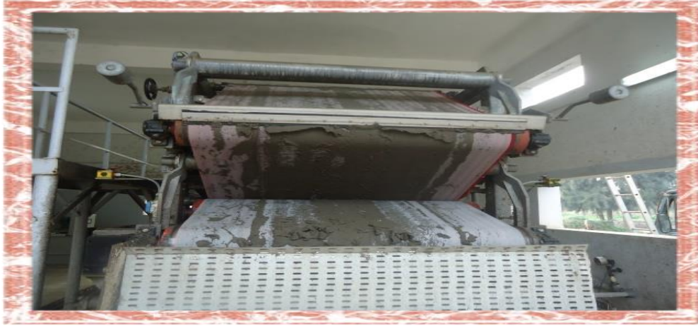
Figure N°14 : Déshydrateur mécanique (photo originale)
