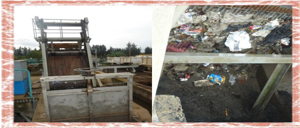
Figure N°04 : Dégrilleurs grossier (photo originale)
