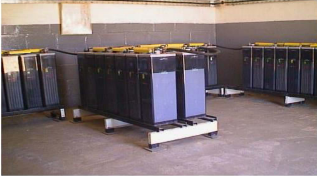
Figure 1.7: Batteries stationnaires au plomb acide pour système photovoltaïque (Tahifet –Tamanrasset) [19].
