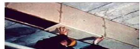
FIGURE 124: protection par plaque Source : site web : //www.google.dz/
