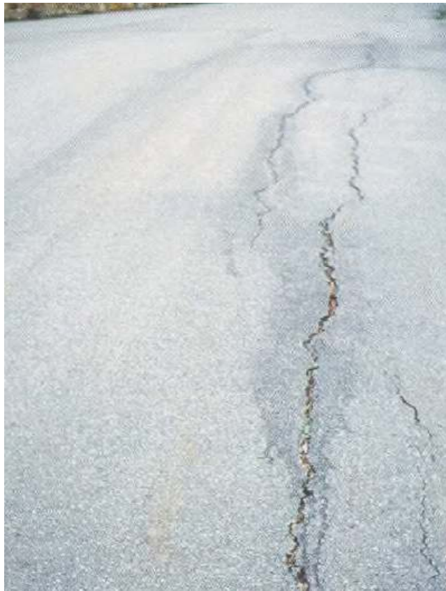
Figure 16. Fissuration longitudinale sur une chaussée
