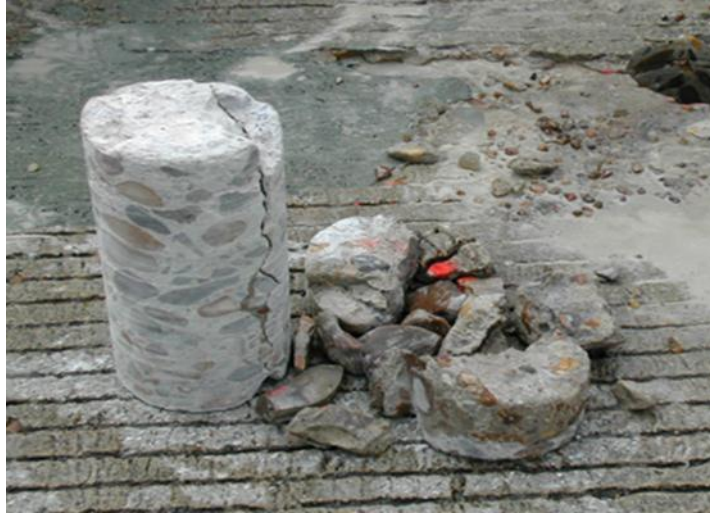
Figure I.29 : Carottage adjacent à la zone réparée écaillée [6].
