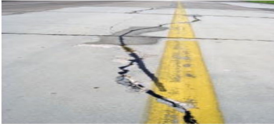
Figure I.10 : fissures au niveau de la chaussée [5].
