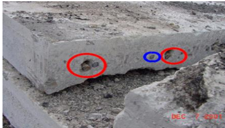
Figure I.26 : Dalle déjà réparée [6].
