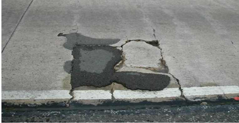
Figure I.21 :Punch-out typique dans CRCP [6].
