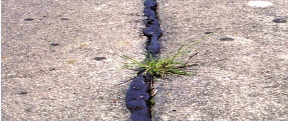
Figure I.18 : défaut de joint [5].
