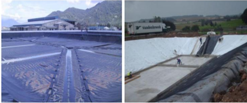
Figure II.26 : les géo-synthétiques dans les bassins de traitement [9].
