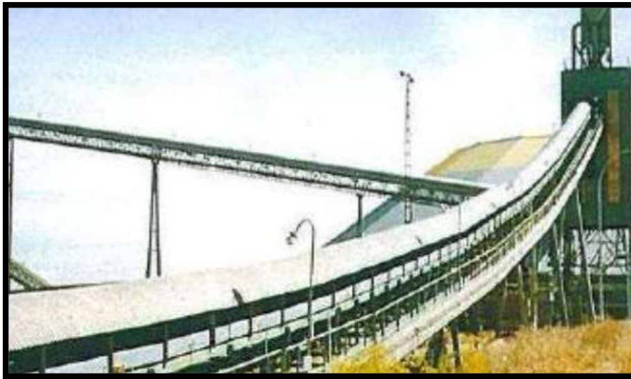
Figure (1.3) : Vue générale du convoyeur à bande.
