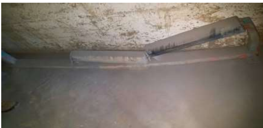
Figure (2.1) : les stations qui montre le problème de flexion
