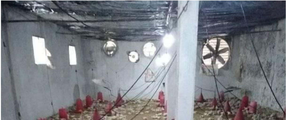
Figure 18. Système de ventilation.
