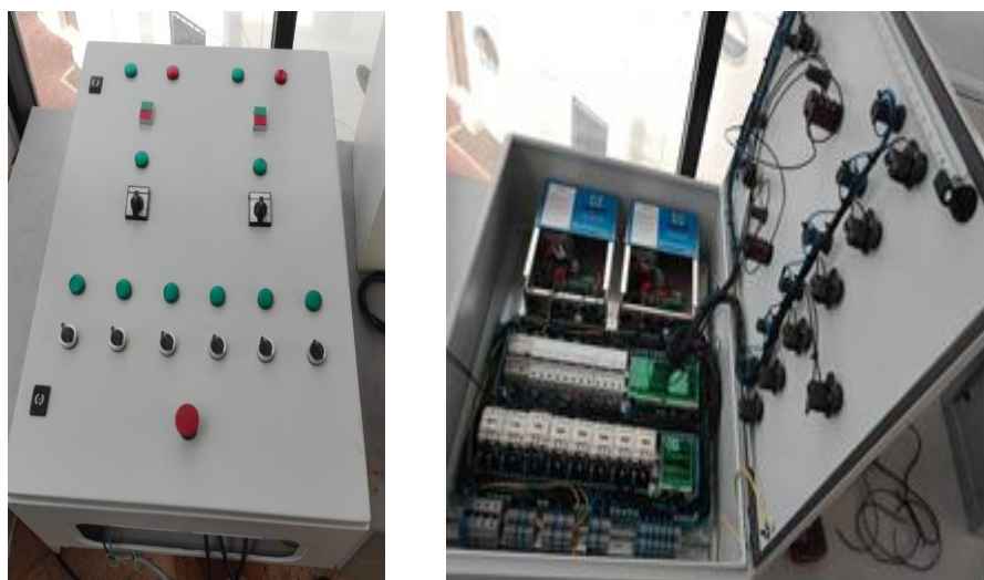
Figure 5.19 : Armoire de commande et de régulation électrique réalisée à l'UDES
