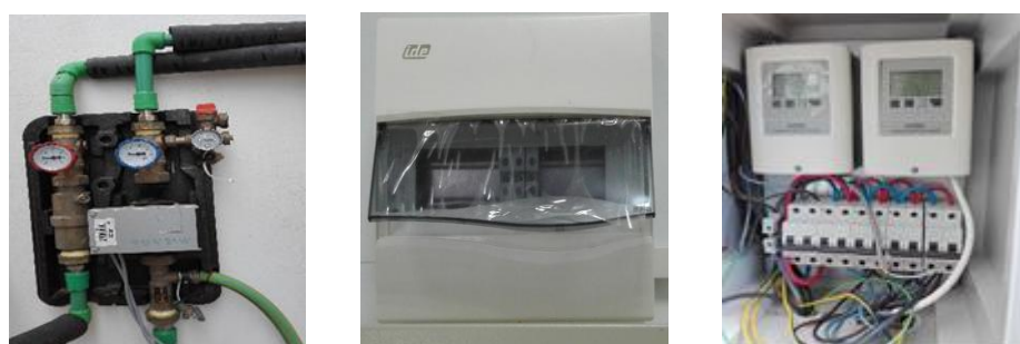
Figure 5.16 : Pompes et système de commande du ballon de stockage
