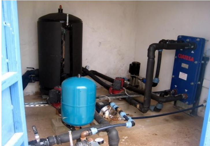
Figure 1.8 : Pompe à chaleur installée dans une école primaire à Saida[19].
