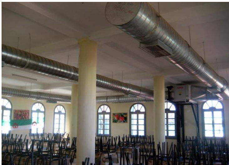
Figure 1.9 : Cantine de l'école primaire alimentée par climatisation géothermique [19].
