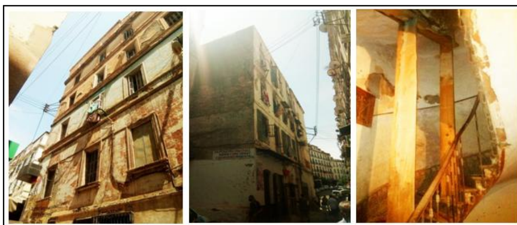
Figure.III. 21. Etat extérieur du bloc menacé d'effondrement ( à gauche Bloc :N°2/ilot N°13, au milieu bloc N°1/ilot N°16 et à droite bloc :N°3 /ilot N°10 ) Source .Auteur
