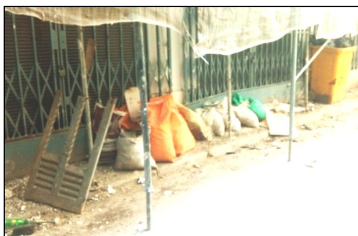
Figure.III. 26. Point de collecte des déchets de chantier, à coté du bâtiment N°1/ ilot N°12 Source. Auteurs
