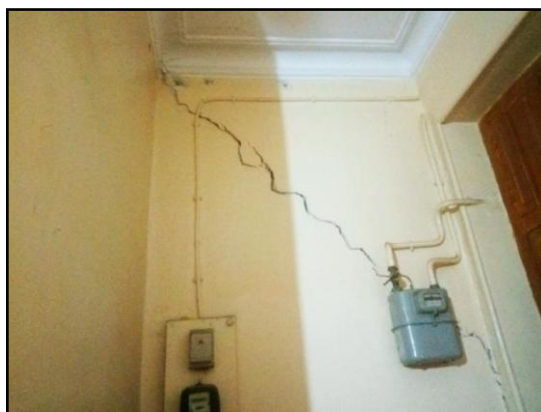
Figure.III. 20. Fissure oblique dans un logement dépendant d'un bloc menacé Source .Auteurs.
