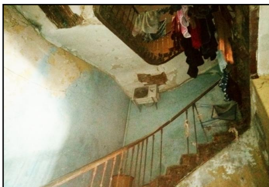
Figure.III. 22. Espace commun (Escalier) mal entretenu, dans le bloc N° 10 /ilot 13mal entretenus (Source. Auteurs).
