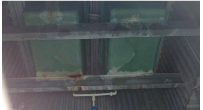
Figure 7: la bâche à eau (photo personnel)
