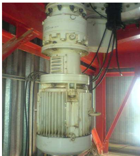
Figure 3.21 : Moteur tournant l'antenne (photo prise à la station radar d'El-Oued).
