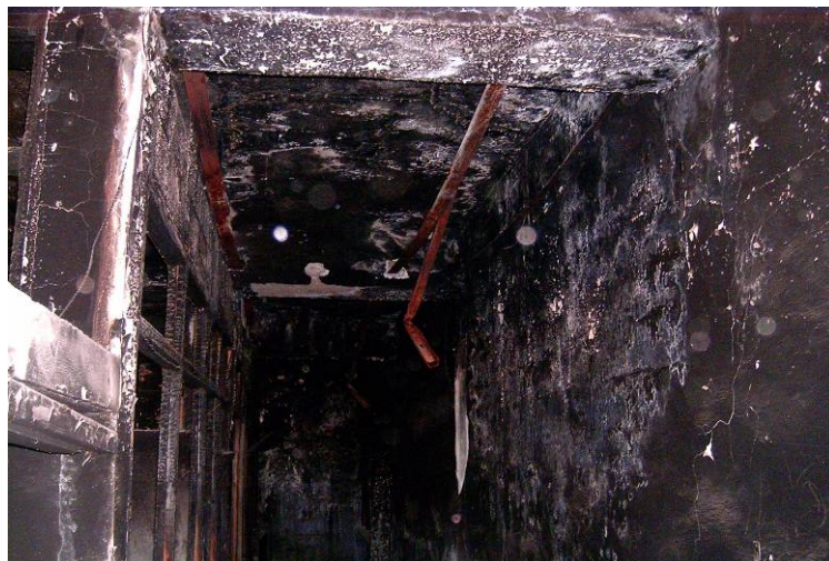
Figure 5.46 : La structure a subi un feu durant sa vie.
