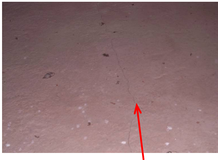
Figure 5.21 : Présence de fissurations dans les dallages.
