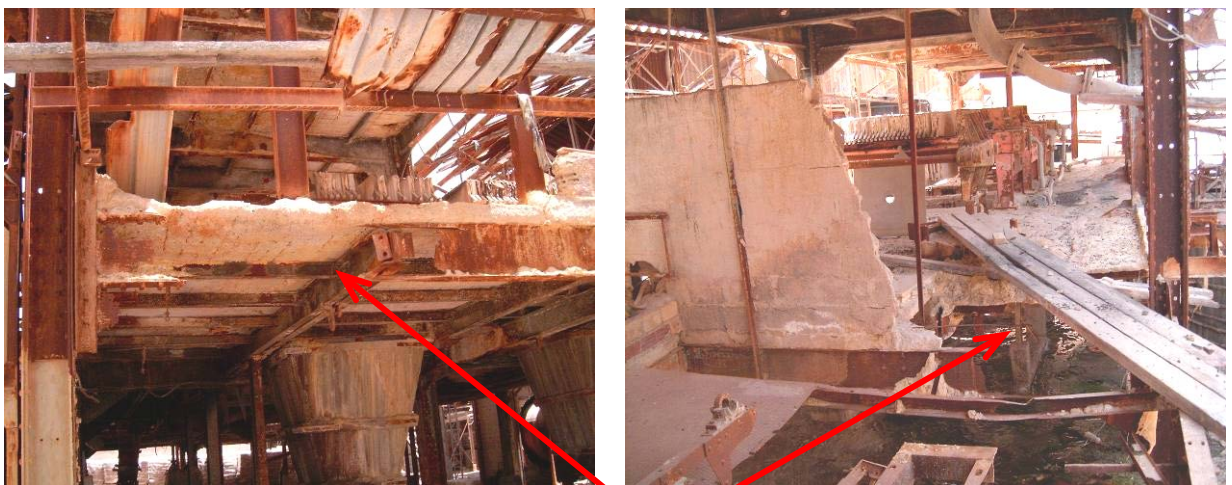
Figure 5.28: Altération profonde des poutres et des planchers.
