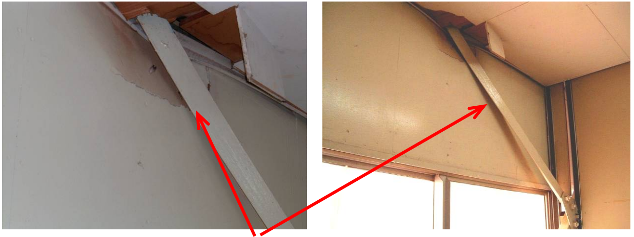
Figure 5.10 : Autres phénomènes d'instabilité sur les barres des contreventements.
