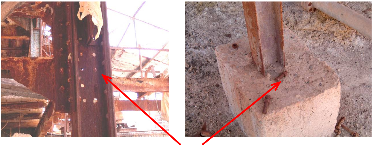
Figure 5.27 : Manque de boulons et endommagement des assemblages.
