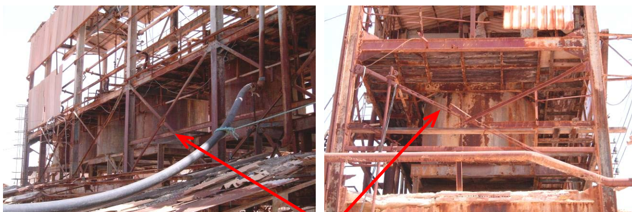
Figure 5.25 : dégradations subies : système de contreventement.
