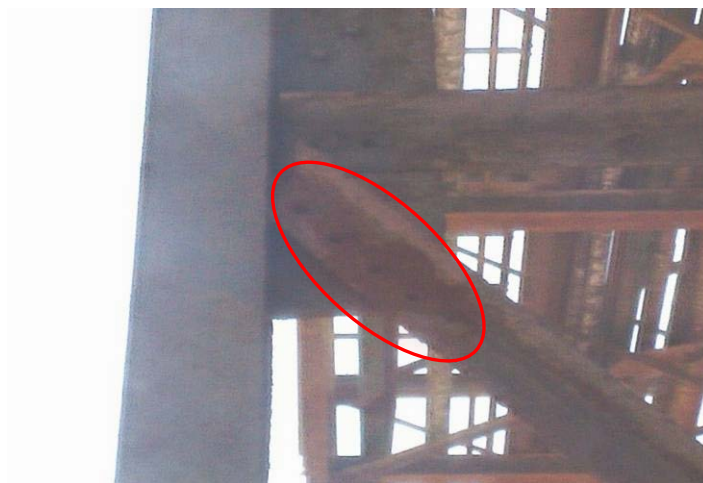
Figure 5.49 : Manque de boulons dans les assemblages.
