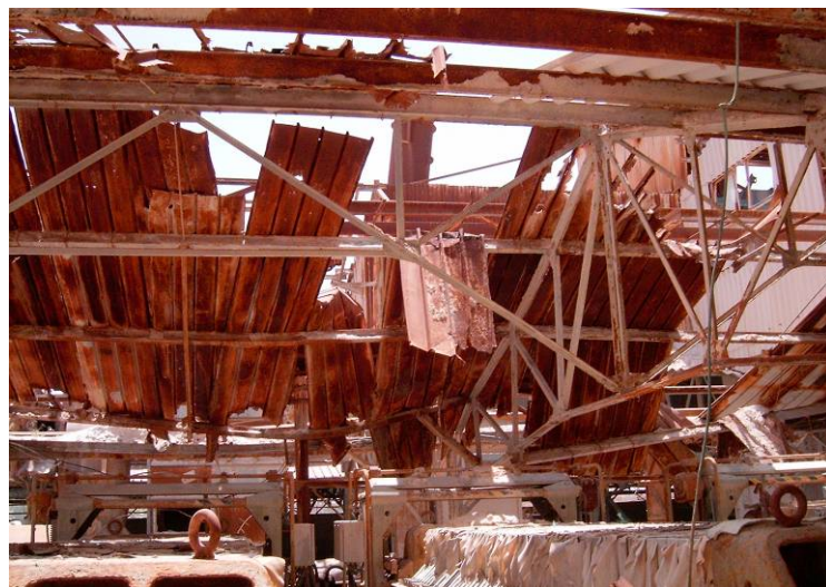
Figure 5.31: Très mauvais état du bardage et de la toiture.
