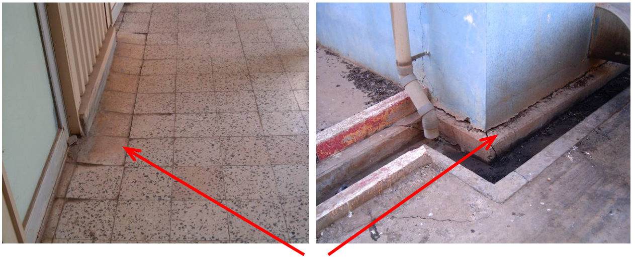
Figure 5.11 : Ouverture des joints de revêtements et fissures à la base des murs.
