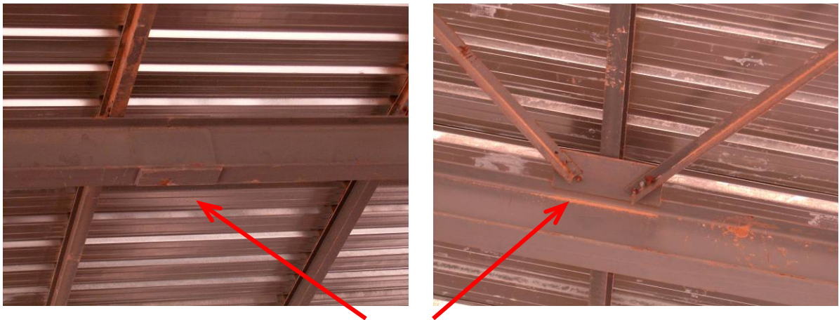
Figure 5.36 : Malfaçons dans les assemblages.
