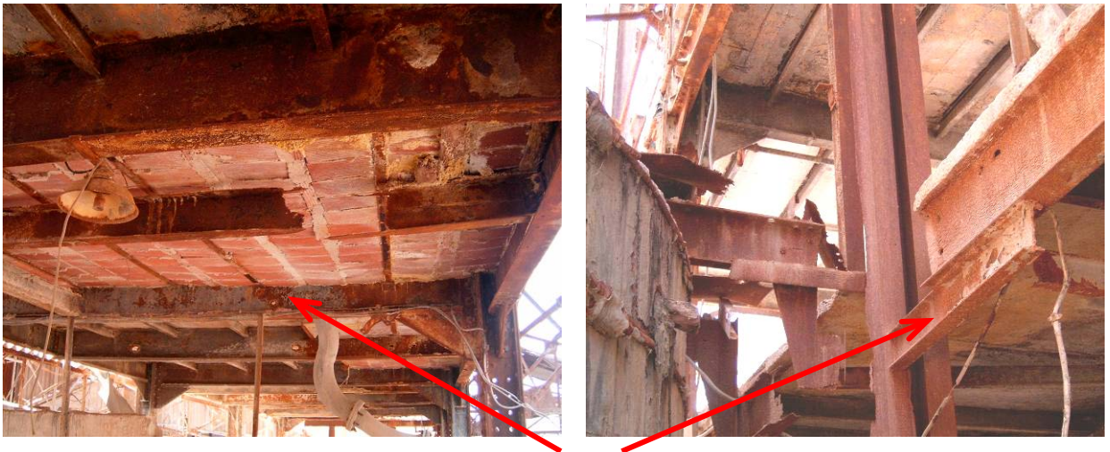
Figure 5.30: Effondrement de la dalle de plancher et réparations archaïques.
