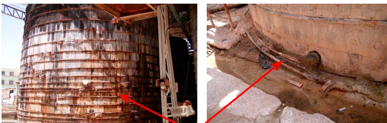
Figure 5.33: tirants de cuves de stockage : Corrosion très avancée avec dégradations.
