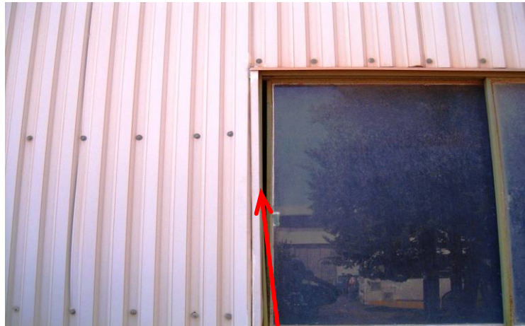
Figure 5.13 : Décalage de la fenêtre dû à l'affaissement du terrain
