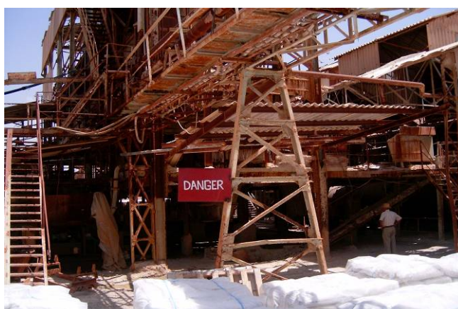
Figure 5.34: Panneaux danger expriment aussi la classification de la structure.
