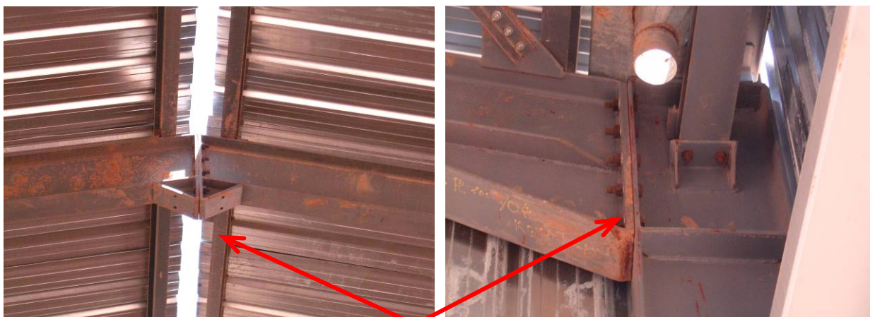
Figure 5.37: Autres malfaçons dans les assemblages boulons pas bien serrés et sans rondelles de serrage.
