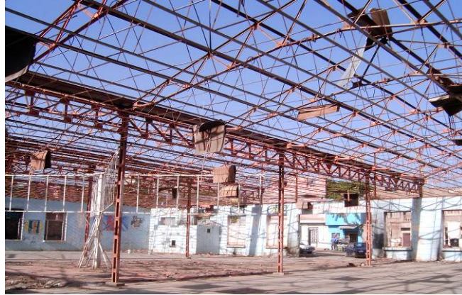
Figure 5.41 : Marché : vu de l'intérieur, absence totale du bardage.
