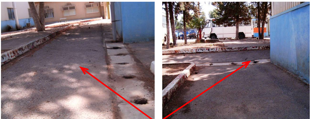
Figure 5.12 : Affaissement du terrain.
