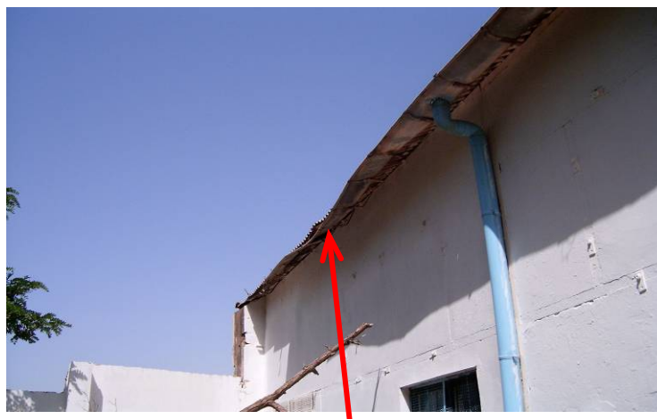
Figure 5.22 : Dégradation des descentes d'eaux pluviales.
