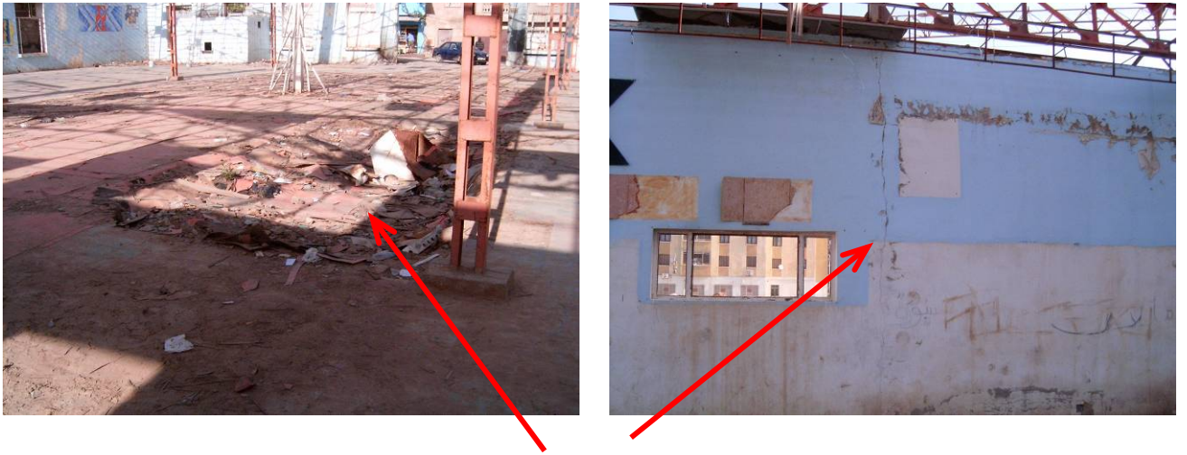
Figure 5.44 : Affaissement du dallage et présence de fissuration dans les murs.
