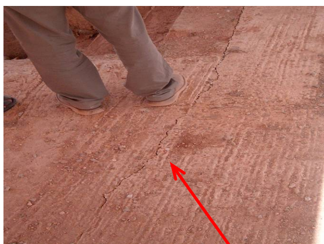
Figure 5.39 : Fissure dans les dallages.
