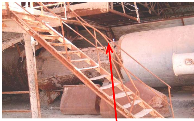
Figure 5.32: Escalier et garde corps en piteux état.
