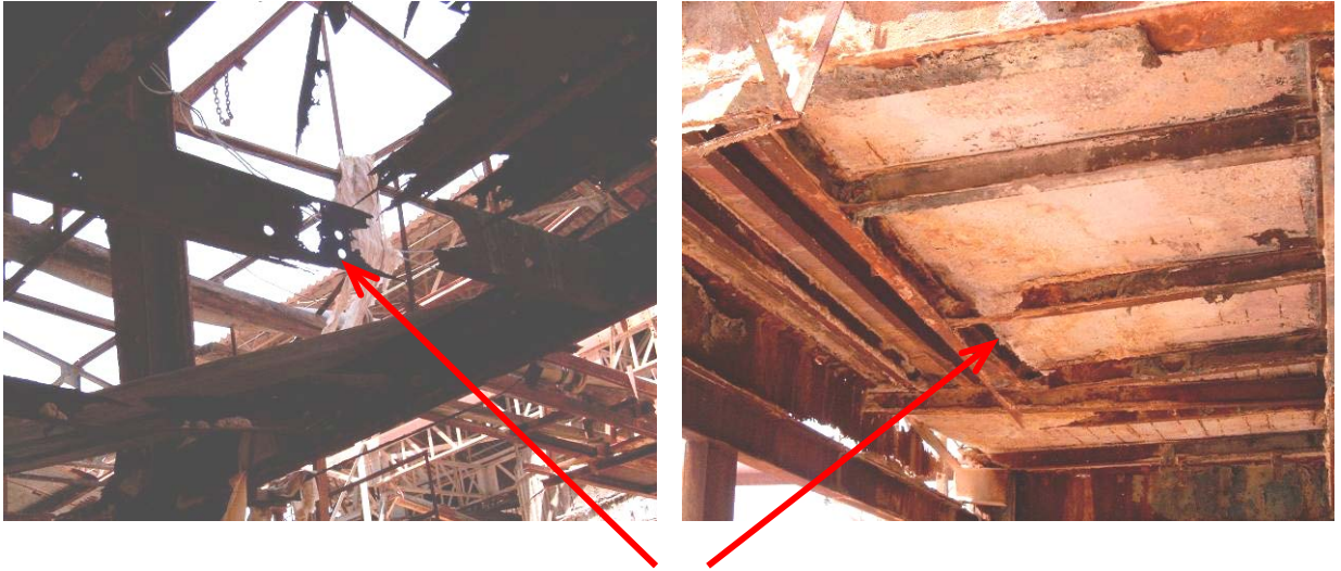
Figure 5.29: Autres dégradations dans les planchers et les poutres.
