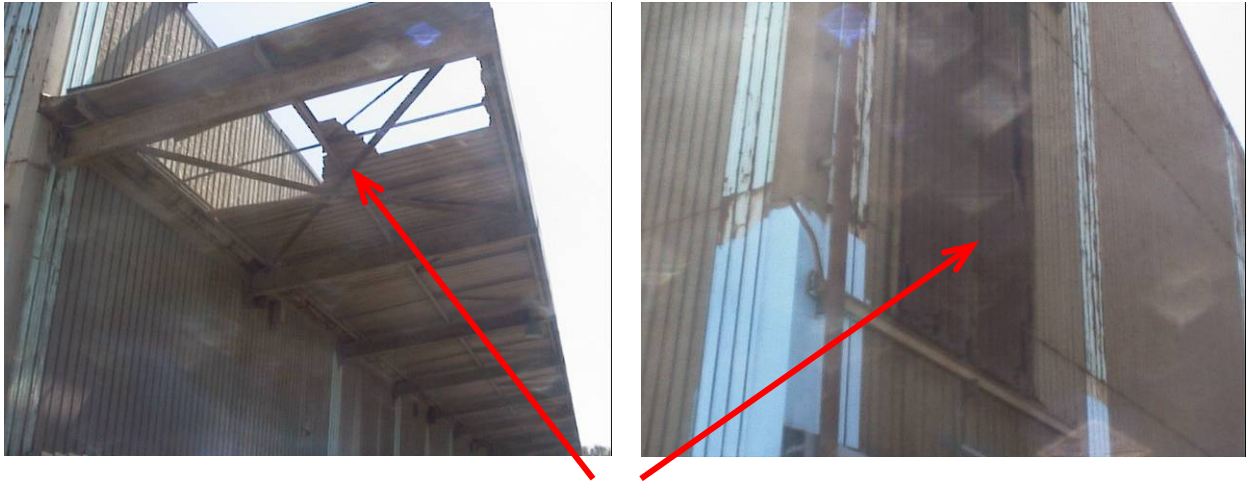
Figure 5.55 : Dégradation du bardage.
