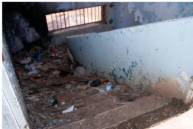
Figure 5.42: État de l'escalier et du garde corps.
