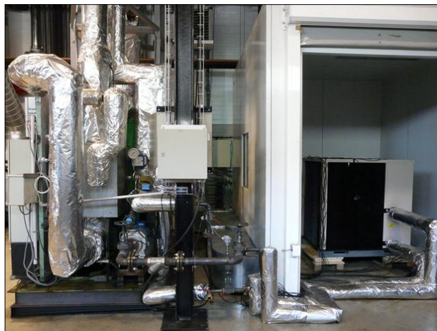
Figure.3.3. Banc d'essai multifonctionnel pour la caractérisation des pompes à chaleur, les refroidisseurs et les moteurs thermiques de petites puissances (CREVER. [104])
