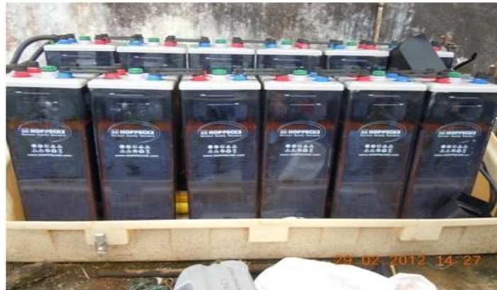
Figure (I.26): Parc constitué de 12 éléments de batteries ouvertes de 2V (Capacité 800 Ah - Tension 24 V) [18].
