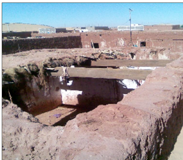
Figure 4-79 : Une maison en toubé sérieusement endommagée par les pluies. Source : Google image
