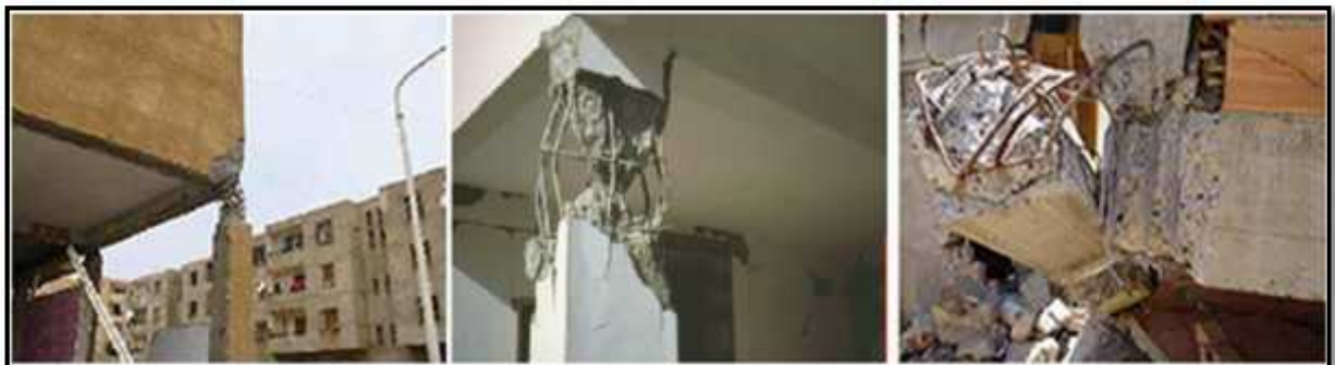
Figure III.3. 10: les catastrophes des séismes. (Source : béton-blindé.fr)
